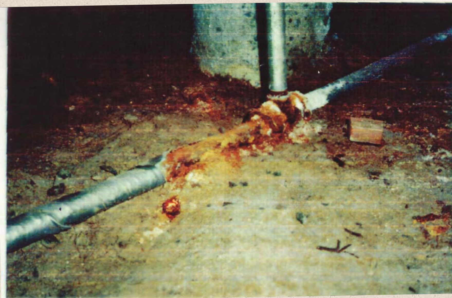
豊浜団地 水道管の腐食状況
